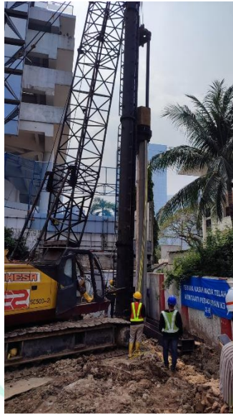
Gambar 3.14 Drive Cap telah tersambung dengan CCSP
