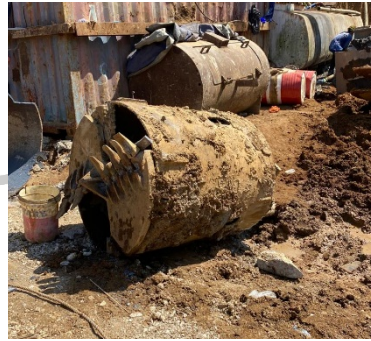
Gambar 3. 64 Mata Bor yang mengalami kerusakan (Sumber : Dokumentasi Pribadi)
