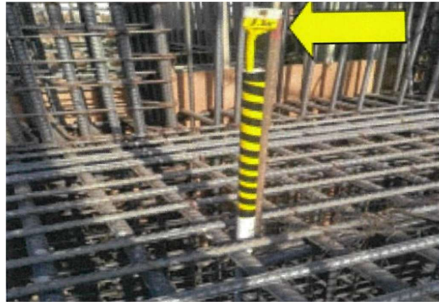
Gambar 3. 44 Thermocouple (Sumber: Dokumen Pekerjaan PP BNI PIK 2, 2024)
