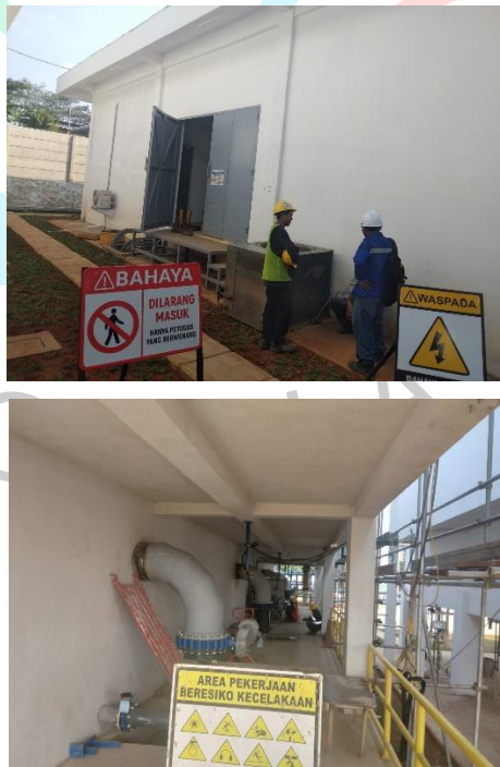
Gambar 3. 7 Rambu-Rambu Keselamatan Kerja Proyek IPA
