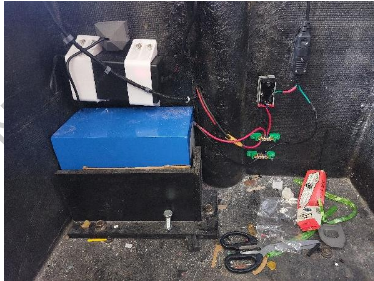
Gambar 4.19. Foto Fitting Baterai
