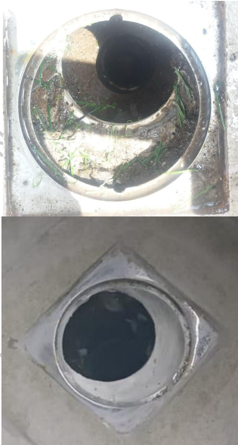
Gambar 3.29 Floor drain dan pipa pembuangan tidak simetris (sebelum dan sesudah)
