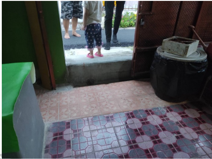
Gambar 3.6. Perbedaan Level Jalan dan Rumah
