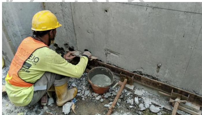
Gambar 0.52 Perbaikan Beton Keropos di Core Wall
