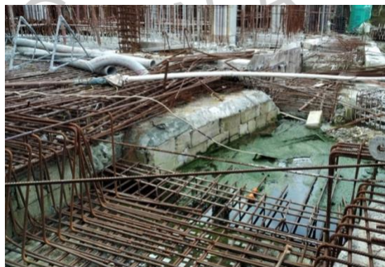
Gambar 0.55 Kondisi Besi Tulangan di Oceanarium
