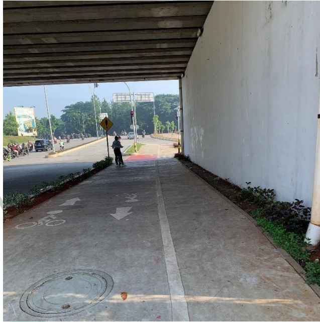
Gambar 4. 13 Pengaplikasian Manhole , serta jalur yang merata (Sumber: Dokumen Pribadi, 2021)
