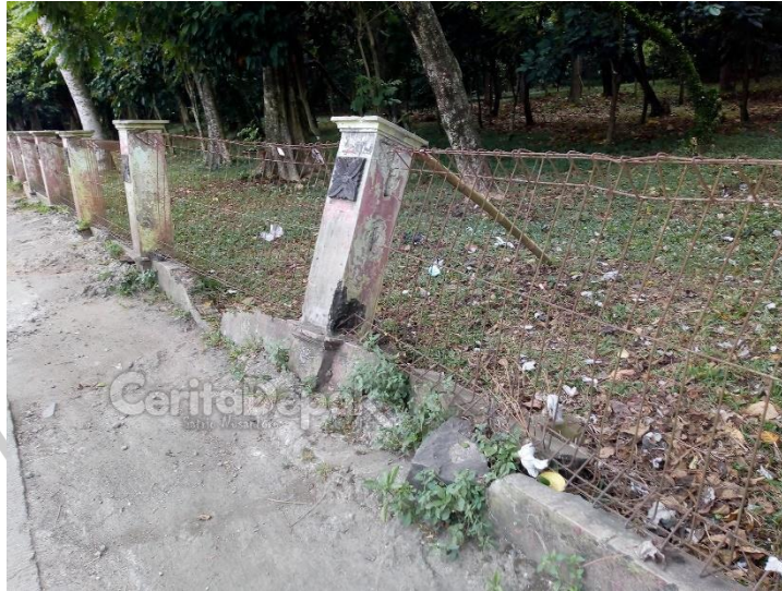
Gambar 1. 1 Pagar Cagar Alam Depok roboh Sumber: (Nusantoro, 2021)
