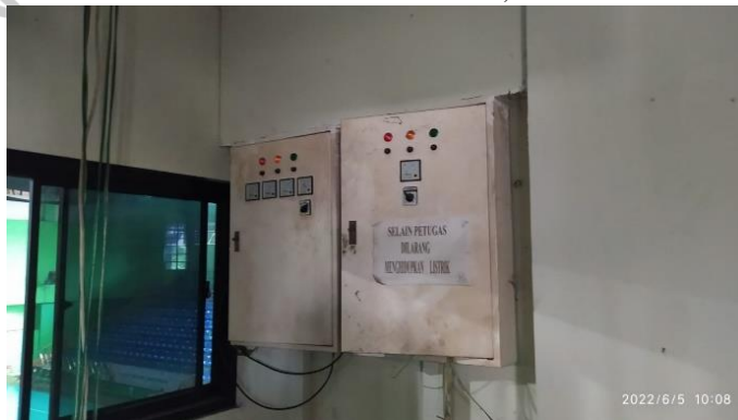
Gambar 4. 21 Ruang Elektrikal GOR Bulungan Gambar 5. 1
