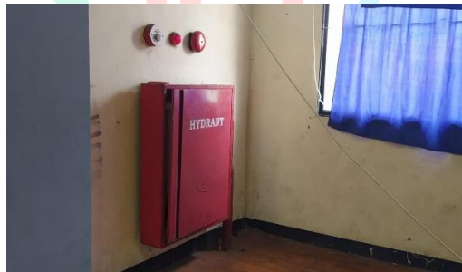
Gambar 4. 30 Fasilitas Hydrant Sumber: Dokumentasi Pribadi, 2022
