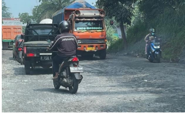
Gambar 3.2 Kondisi Kerusakan Jalan Raya Serpong Ruas Muncul – Gn. Sindur
