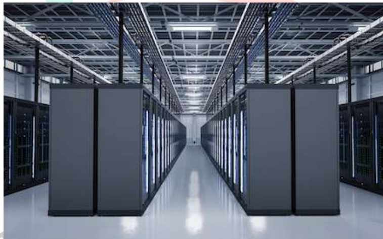
Gambar 3.4. Ilustrasi Fasilitas Data Center
