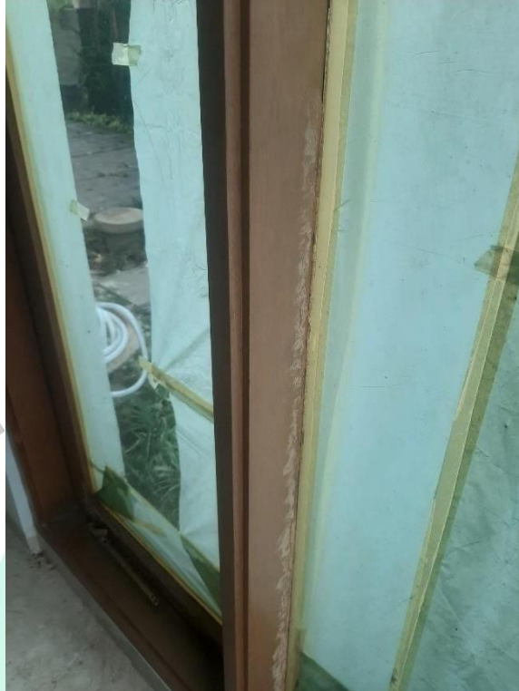
Gambar 3. 47 Kondisi Kusen Kayu
