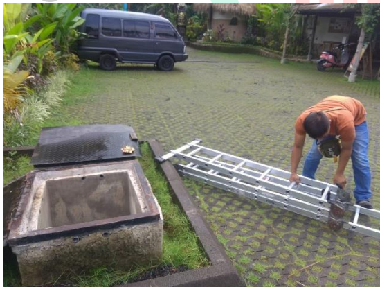
Gambar 4. 3 Pemeriksaan Groundwater Tank untuk Rainwater Harvesting System Sumber : Dokumentasi Praktikkan
