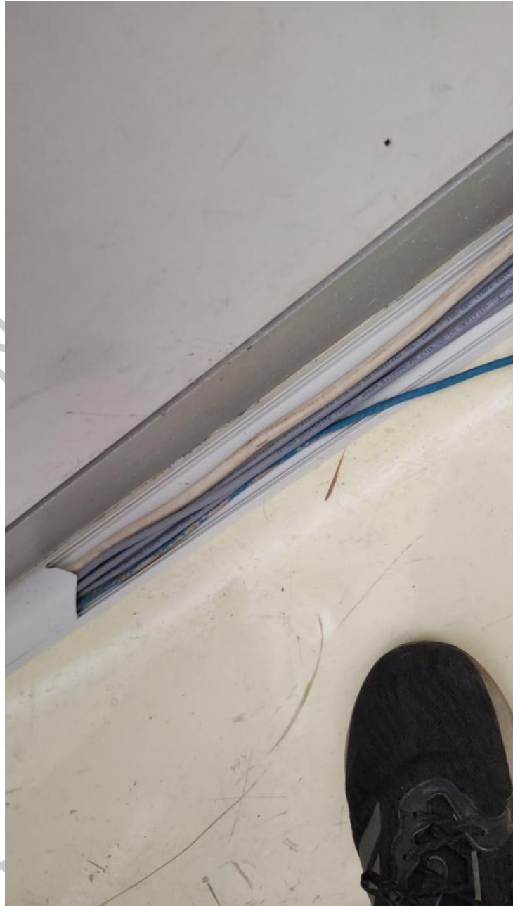
Gambar 3.29 Kondisi Cable Duck di Lab Arsitektur Yang Sudah Rusak Sumber: (Kamera pribadi praktikan)
