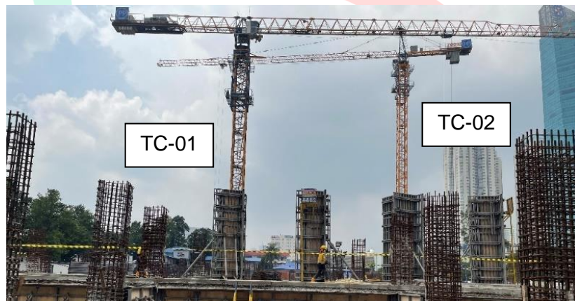
Gambar 3.14 Tower crane (Dokumentasi Pribadi, 2022)
