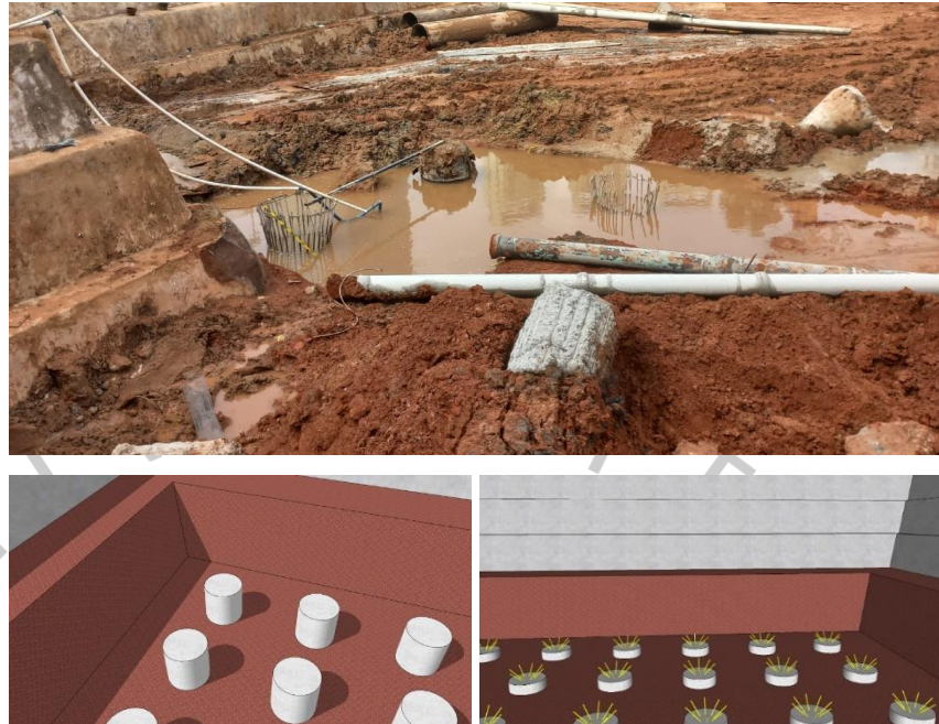
Gambar 3.35 Ilustrasi pemotongan dan pembobokan bored pile untuk raft foundation (Dokumen proyek KSO PT PP (Persero) Tbk – PT Arkonin, 2022)
