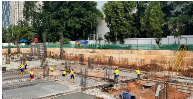
Gambar 3.7 Safety Railing (Dokumentasi Pribadi, 2022)
