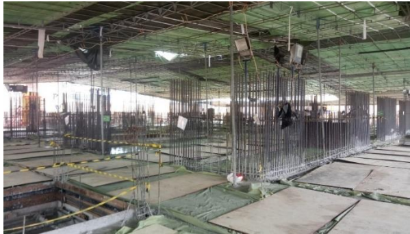
Gambar 3.66 Proses curing dengan triplek dan plastik cor untuk raft foundation (Dokumentasi Pribadi, 2022)
