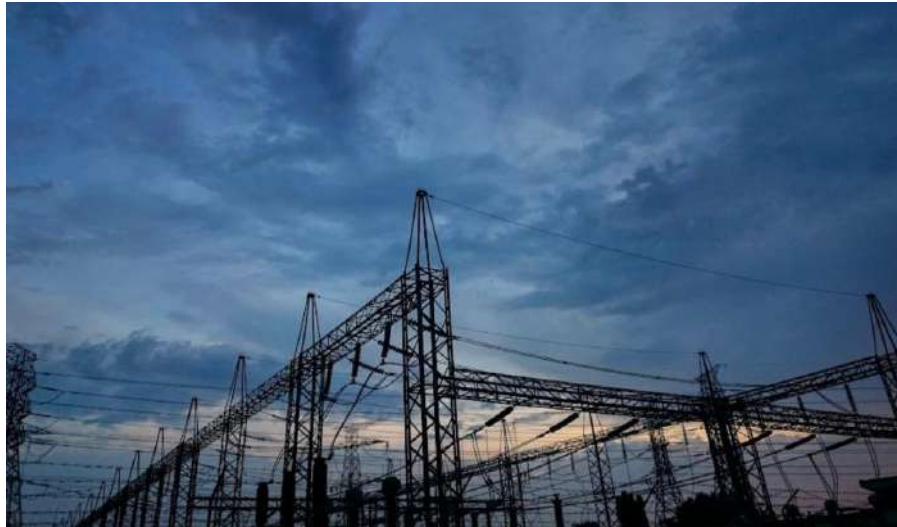
Gambar 2 3 Infrastruktur Kelistrikan PT PLN (Persero) UIP JBB Sumber : google.com
