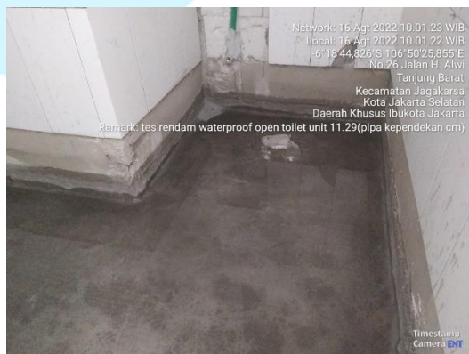
Gambar 3. 20 Contoh pipa terlalu pendek (Sumber : Dokumentasi pribadi)
