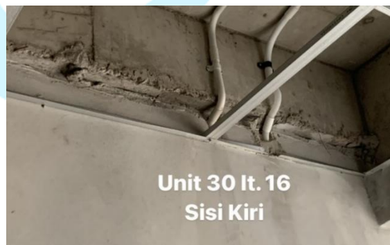
Gambar 3. 27 Beton yang keropos (Sumber : Dokumentasi pribadi)
