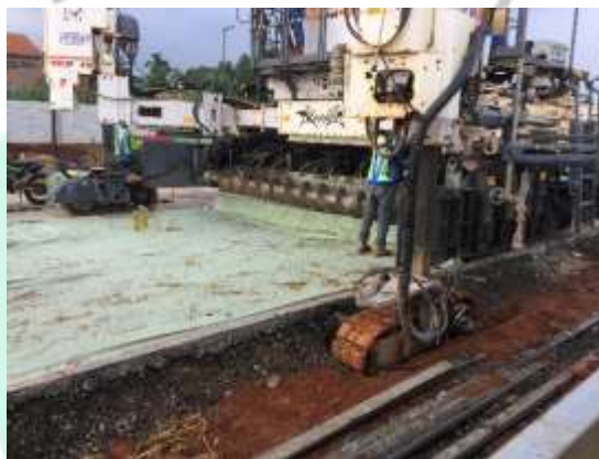
Gambar 3. 49 Terhambatnya Mesin Concreat Paver
