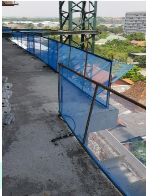
Gambar 3.4 Safety Railing (Dokumentasi pribadi Praktikan)
