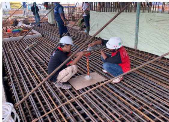
Gambar 3. 18 Thermocouple (Sumber: Dokumen Pribadi)
