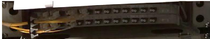
Gambar 3. 30 OTB Distribusi yang Telah di Instalasi
