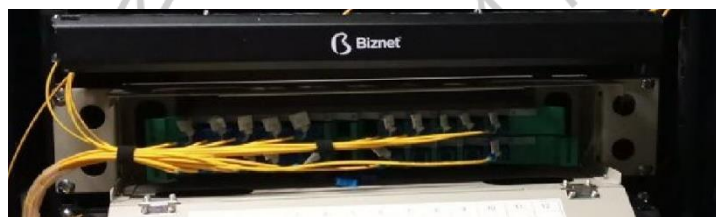
Gambar 3. 31 OTB Splitter yang Telah di Instalasi
