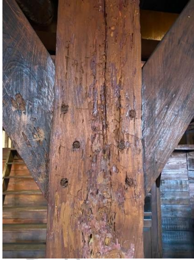
Gambar 4. 27 Pilar yang Sudah Mulai Lapuk
