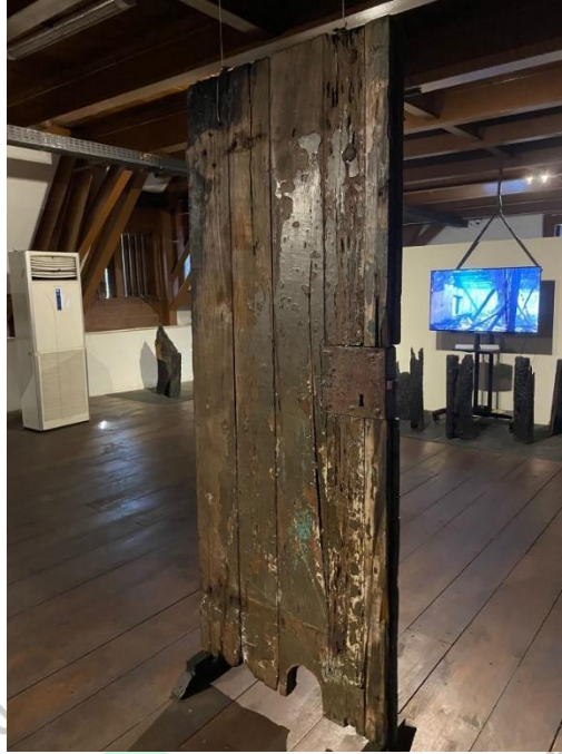
Gambar 4. 5 Material Pintu yang Terbakar
