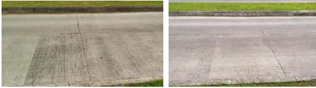
Gambar 5. 7 Kondisi jalan sedang
