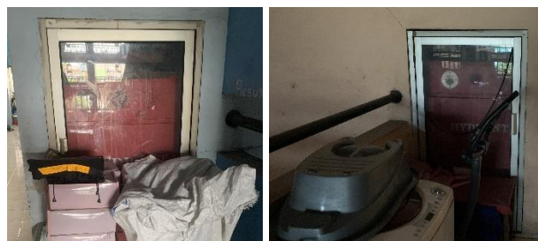
Gambar 4. 18 Kondisi Hydrant yang terhalang oleh barang penghuni (Penulis, 2023)
