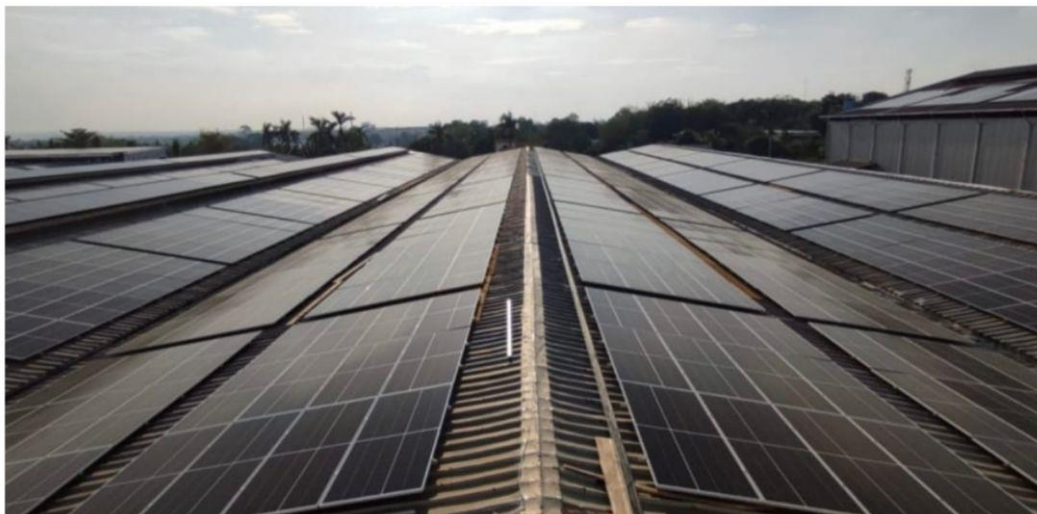
Pabrik Sepatu Nike Kerawang, PLTS On-grid cap 2,1MWp, Tahun 2022
