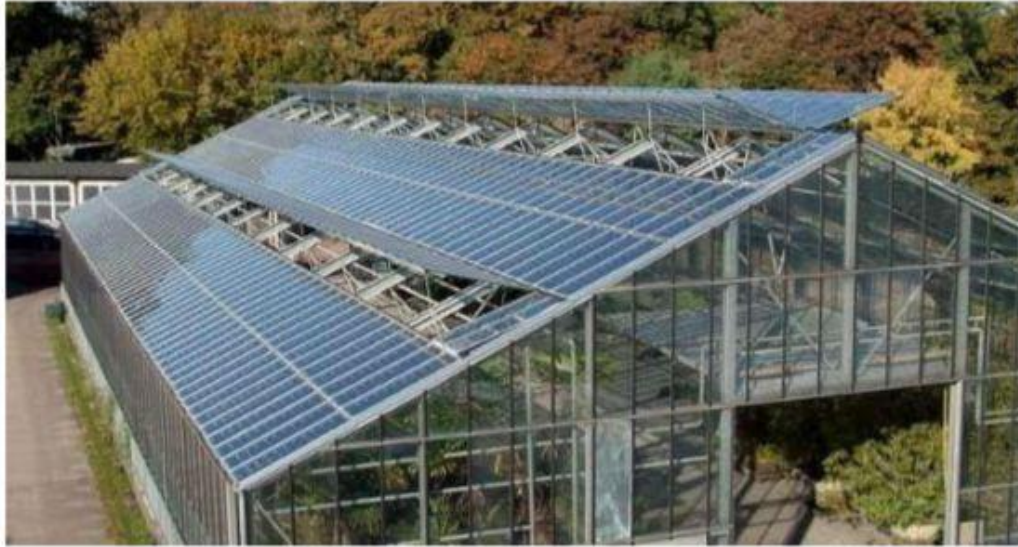
Gambar 2.3.5 Contoh PLTS Hybrid System (Sumber: Data Internal PT Indosolar Energi Mandiri)
