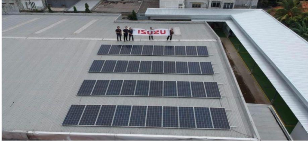
Gambar 2.3.2 PLTS On-grid 10Kwp pada Astra Isuzu Ciputat Th 2021 (Sumber: Data Internal PT Indosolar Energi Mandiri)
