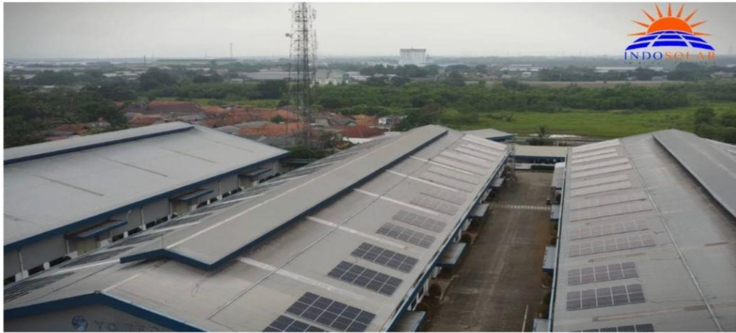
PT. YCTEC Indonesia, Purwakarta, PLTS On-grid cap 682KWp, Tahun 2023
