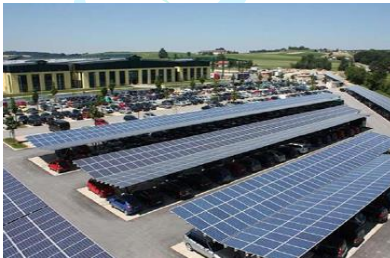
Gambar 2.5 PLTS di atas atap tempat parkir
