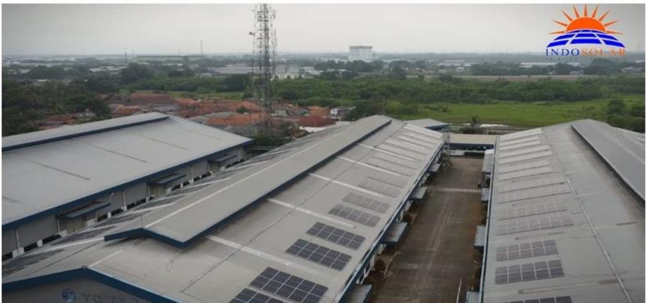
PT. YCTEC Indonesia, Purwakarta, PLTS On-grid cap 682KWp, Tahun 2023
