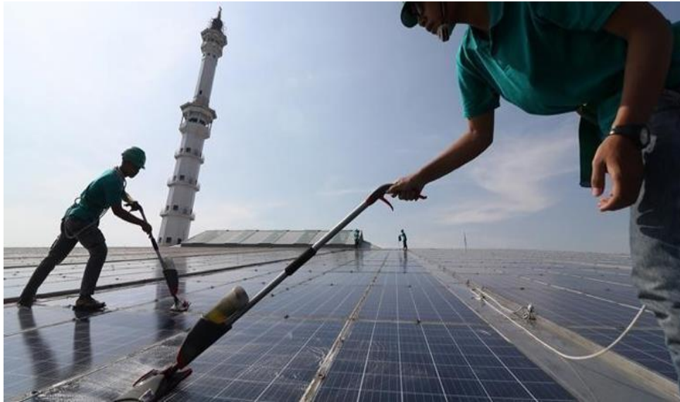
Gambar 2.7 Proses Maintenance PLTS (Sumber: Data Internal PT Indosolar Energi Mandiri)
