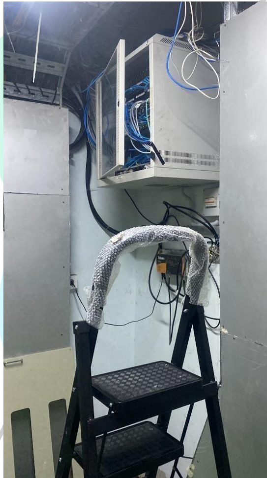
gambar 3. 1 Switch Lt 20 pada Sheraton Jakarta
