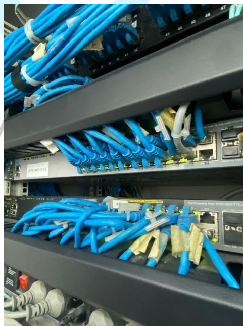
gambar 3.3 contoh jaringan pada switch yang blinking atau nyala
