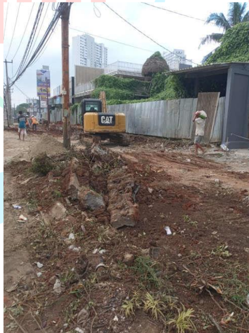
Gambar 3.21 Pengkikisan Tanah Eksisting
