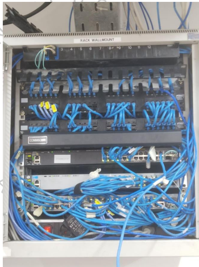
gambar 3. 41 dua tipe switch yang terdapat pada IT office sheraton Jakarta
