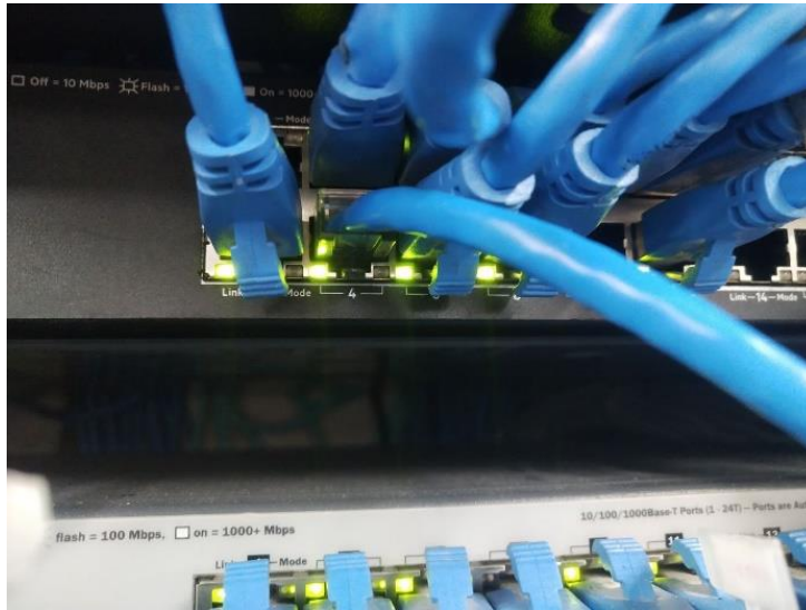
gambar 3. 4 contoh jaringan pada switch yang blinking atau nyala
