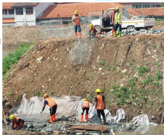
Gambar 3.14 Proses pengisian batu kali pada kawat bronjong untuk pekerjaan Dinding Penahan Tanah (DPT) Bronjong
