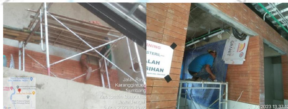
Gambar 3.12 Dinding Bata Tempel Area Toilet Caffe Sumber : Dokumentasi pribadi
