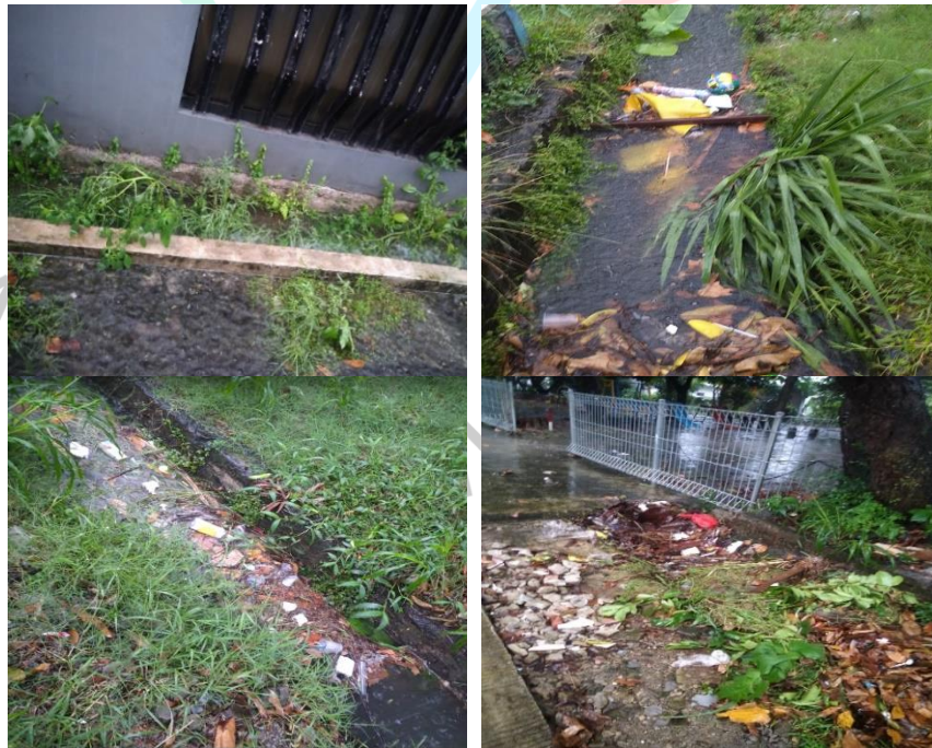
Gambar 4. 10 Kondisi Fisik Drainase Perumahan Pamulang Permai 2 (Dokumentasi Penulis, 3/4/2024)
