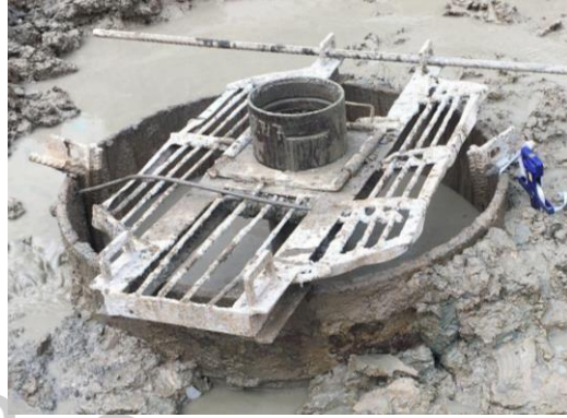
Gambar 3. 63 Penggantungan sementara pipa tremie pada clamp
