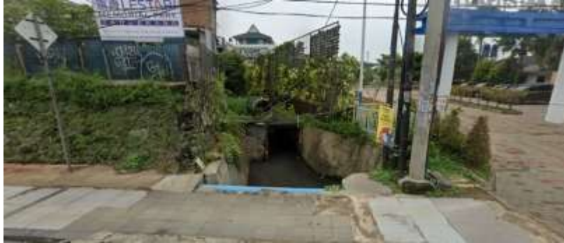
Gambar 3. 11 Kondisi Drainase Tertutup pada Perpustakaan (Sumber : Google Maps, 2024)
